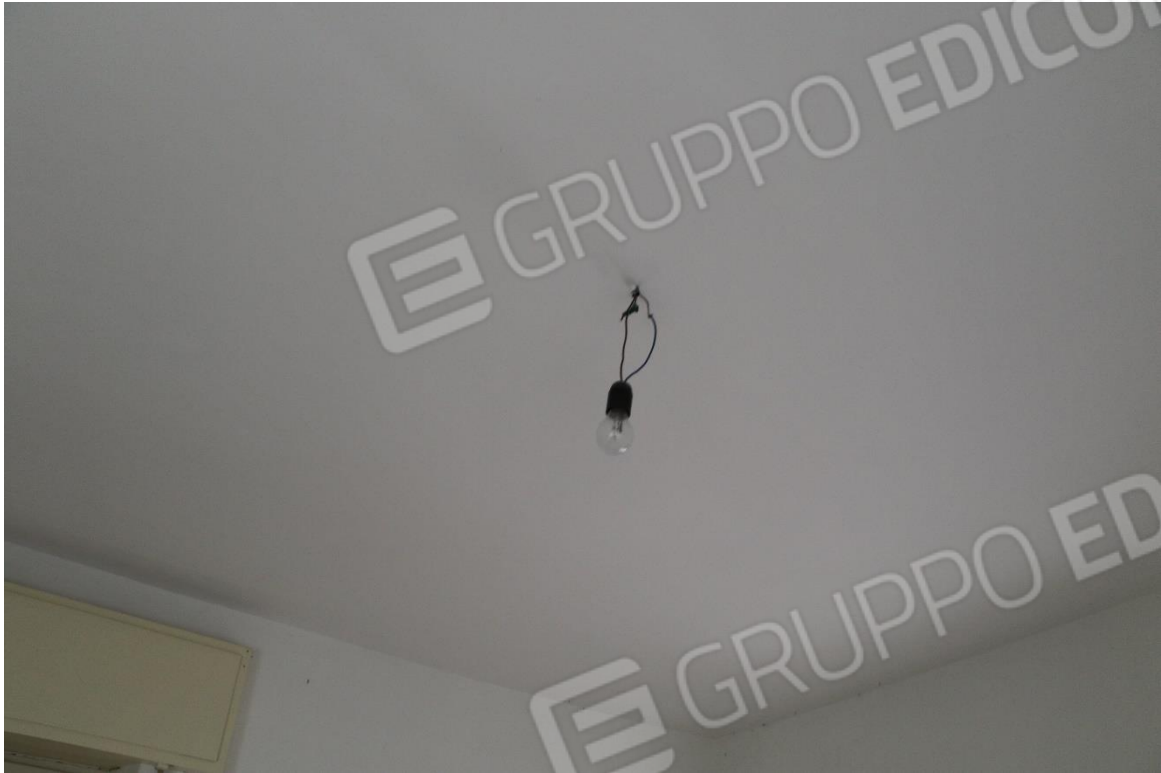
Foto 27 - Lotto 1 - Sub 13 - Illuminazione a soffitto
