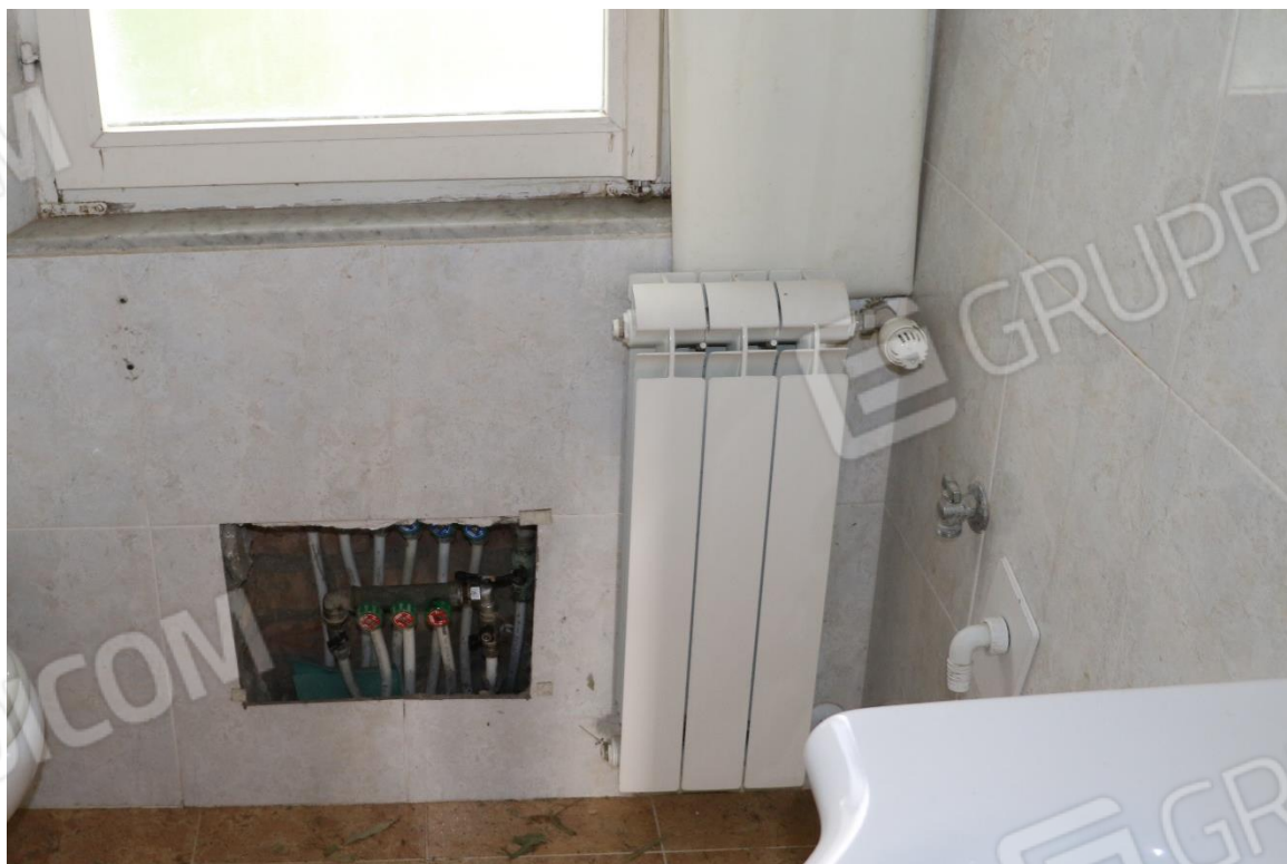
Foto 40 - Lotto 2 - Sub 15 - Radiatori a parete con elettrovalvola
