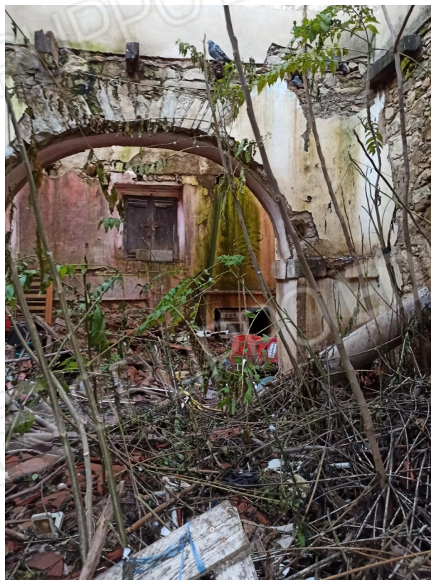
Foto 8 _ Vista interna locale di sgombero collabente
