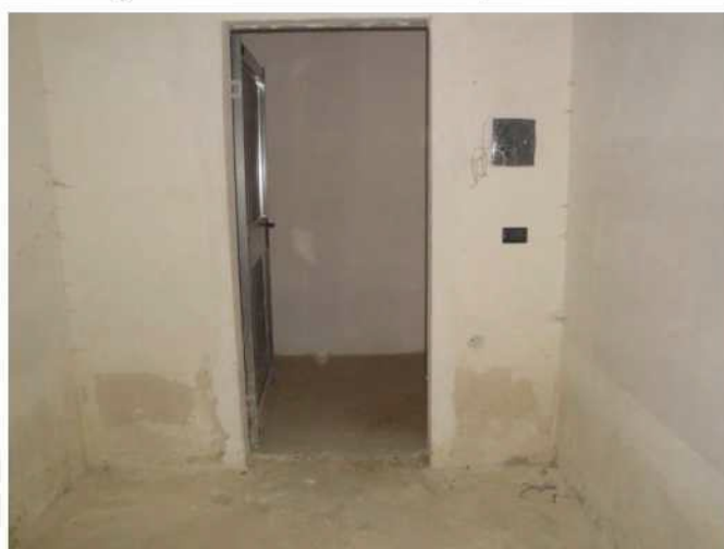
Cantinola piano interrato – segni di umidità da risalita
