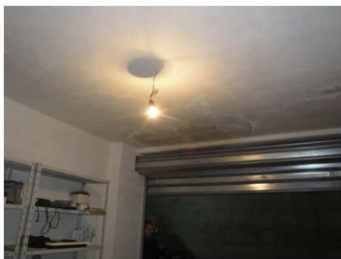
Box piano interrato – infiltrazioni acque meteoriche
