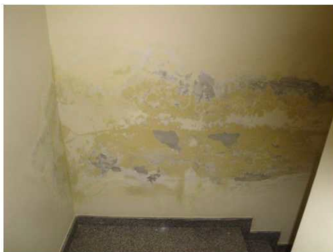
Vano scala piano interrato – infiltrazioni acque meteoriche
