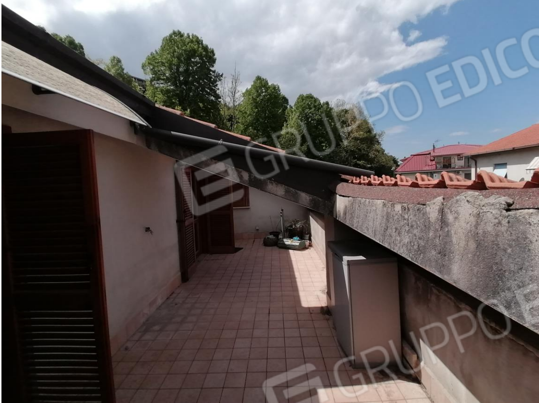
FOTO N°24: Corpo C – Balcone esposto a nord –P3.
