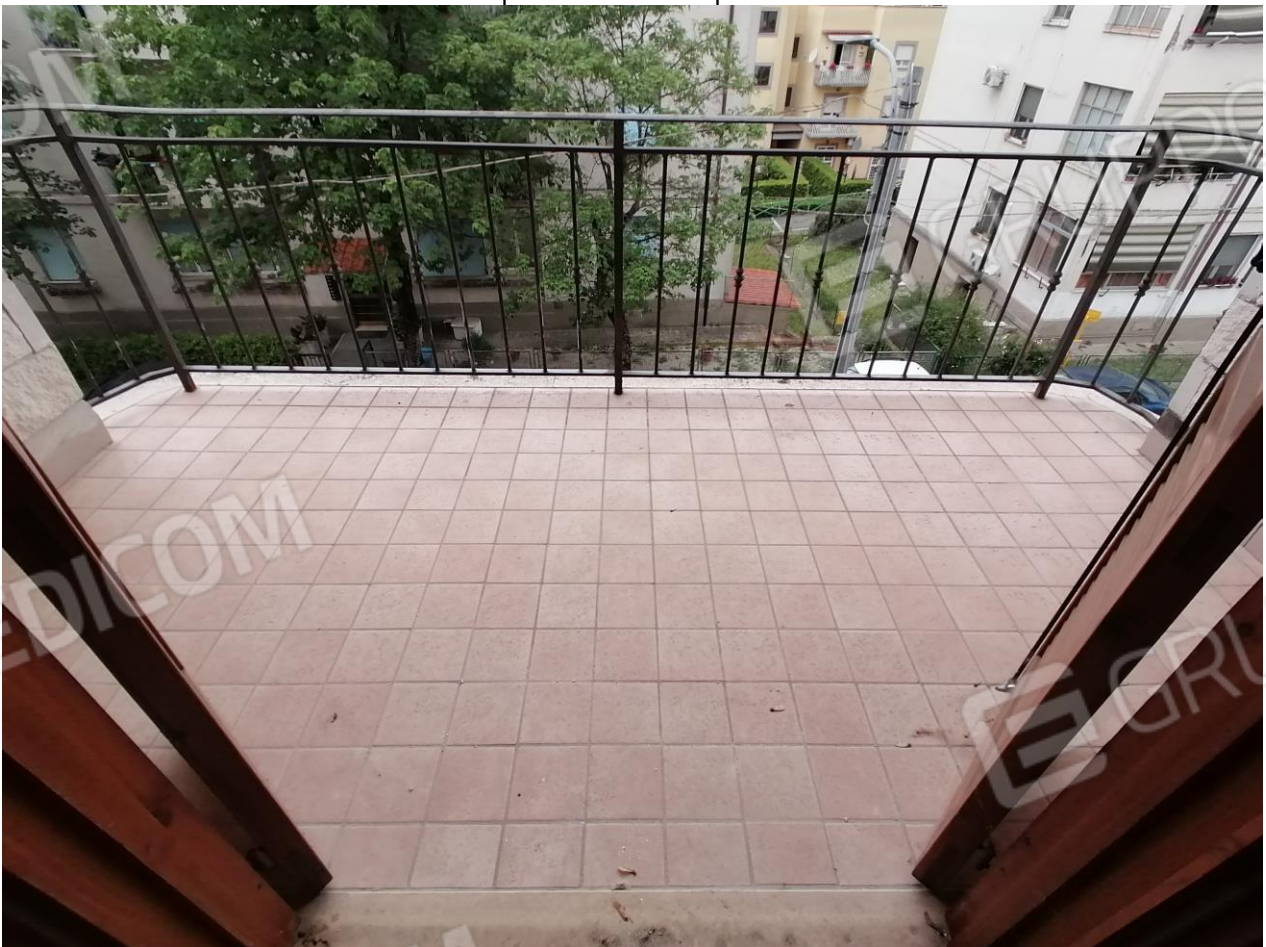
FOTO N°15: Corpo B – Balcone esposto a nord – P2.
