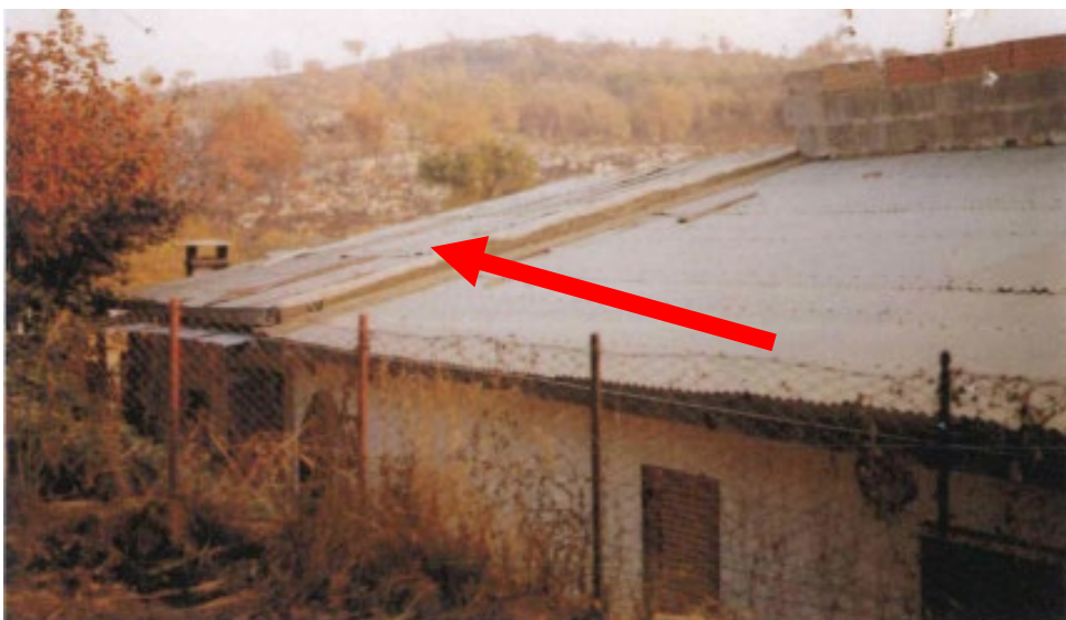
IMMAGINE 3 _ foto allegata alla documentazione a corredo della Licenza edilizia in sanatoria n.181/90 in cui si vede la reale consistenza della "Tettoia".
