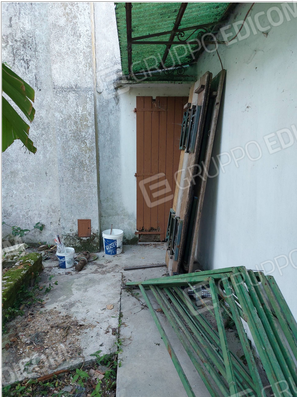
Foto n° 22 - Comune di Annone Veneto, foglio 1, part.1032 – Corte. Visibile la porta di accesso secondaria, che immette nella cucina.
