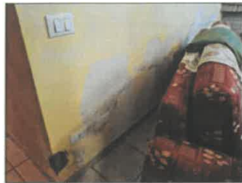
FOTO 63 - UMIDITA' DA RISALITA
