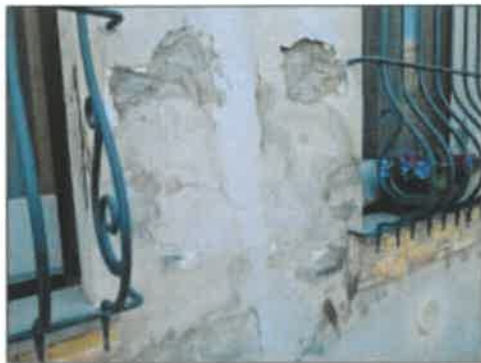
FOTO 55 - ASSESTAMENTI E UMIDITA'
