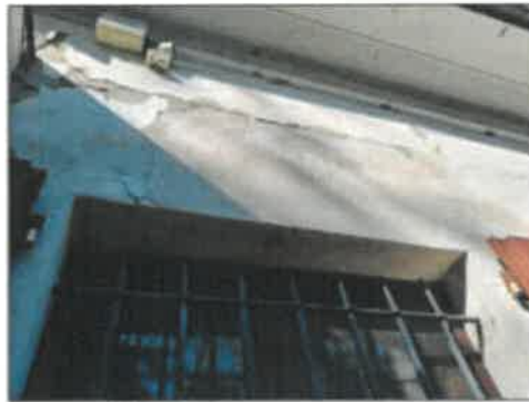
FOTO 56 - ASSESTAMENTI E UMIDITA'
