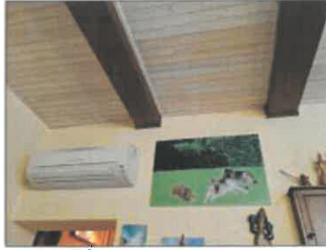
FOTO 50 - RAFFRESCAMENTO UNITA' INTERNA SPLIT
