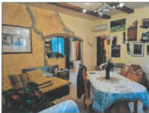
FOTO 62 - ASSESTAMENTI NELLE MURATURE INTERNE
