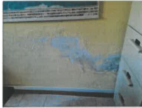
FOTO 66 - UMIDITA' E INFILTRAZIONI
