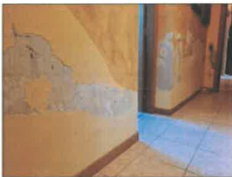
FOTO 65 - UMIDITA' E INFILTRAZIONI
