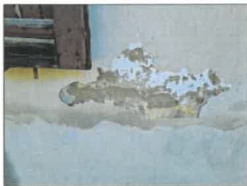
FOTO 58 - UMIDITA' E INFILTRAZIONI
