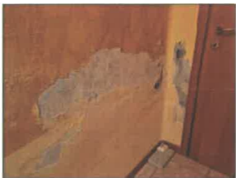
FOTO 64 - UMIDITA' DA RISALITA
