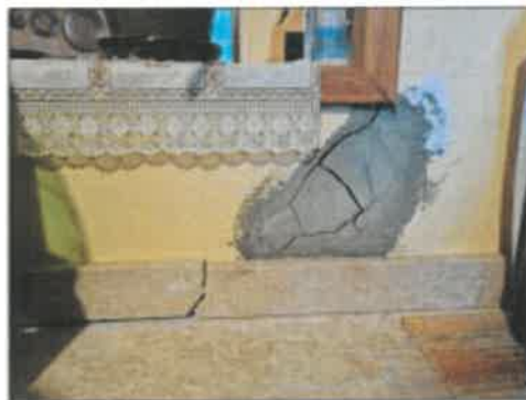
FOTO 59 - ASSESTAMENTI E UMIDITA'
