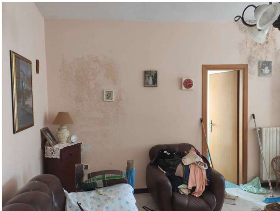
Soggiorno (macchie di infiltrazione)
