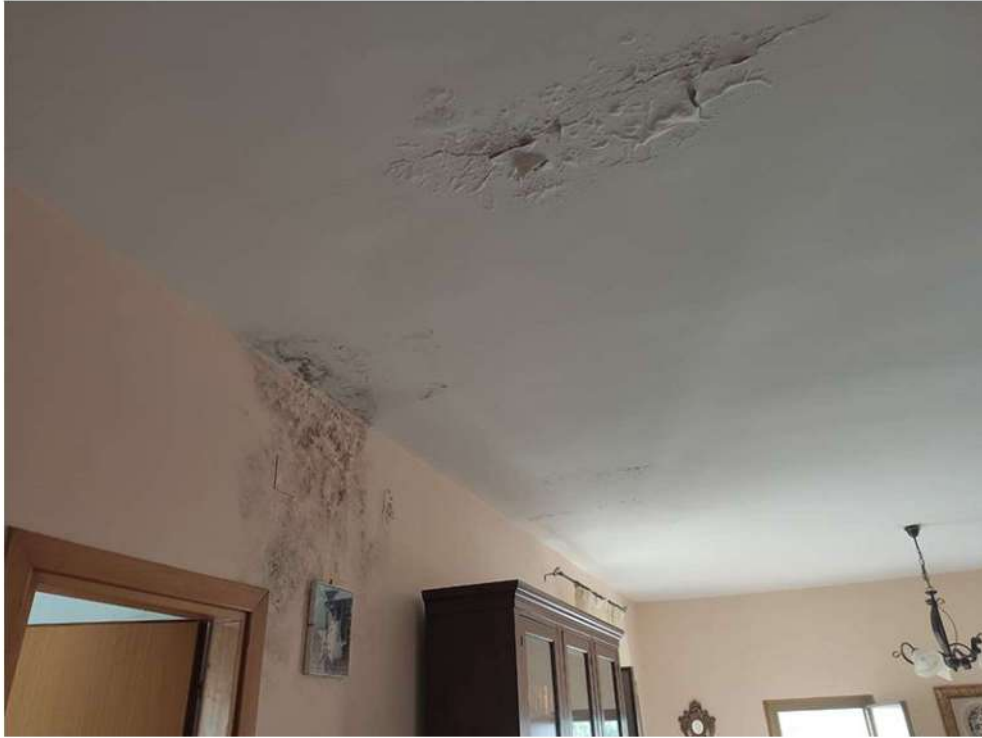
Soggiorno (macchie di infiltrazione)
