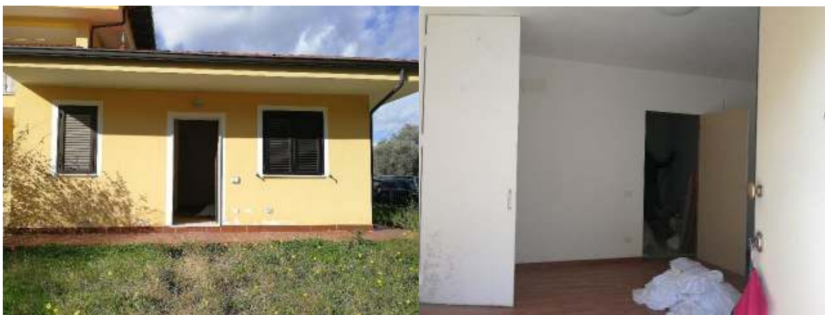
FOTO 2 e 3 – Facciata est e cucina-soggiorno subalterno 15 interno B1.
