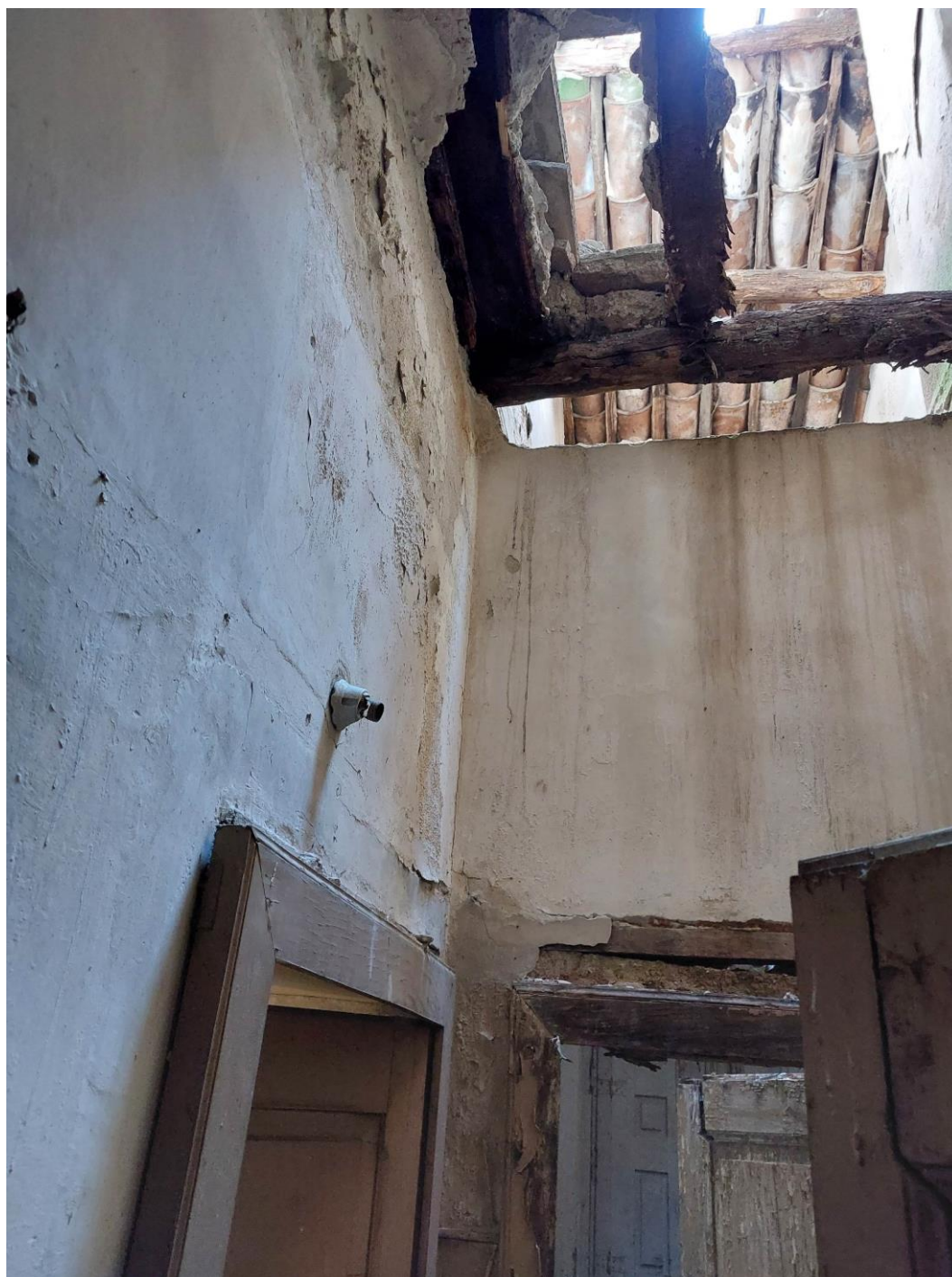
Foto N. 15: Interno del sub.5 solaio di copertura del vano scala crollato (Lotto 1)
