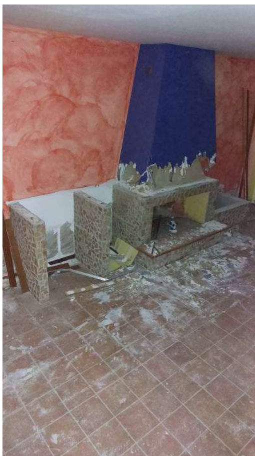
Foto n.32: Piano seminterrato – tavernetta e danni al camino
