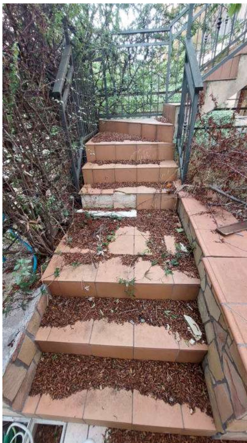
Foto n.8: Scale esterne – danni
