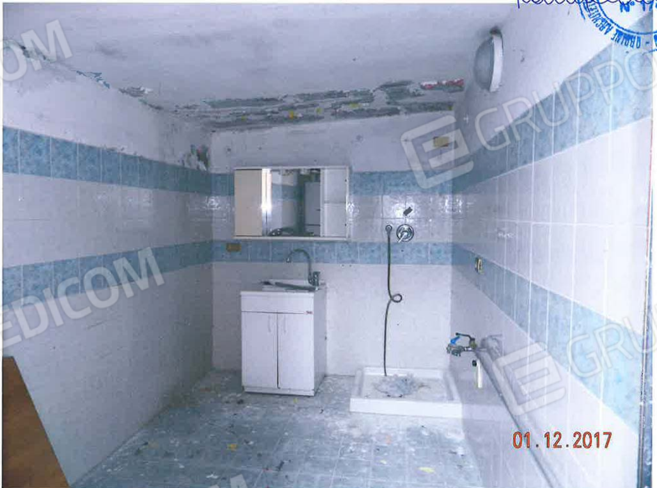
LOTTO 2 – Locale lavanderia/c.t. (sub. 2) – piano terra, interno
