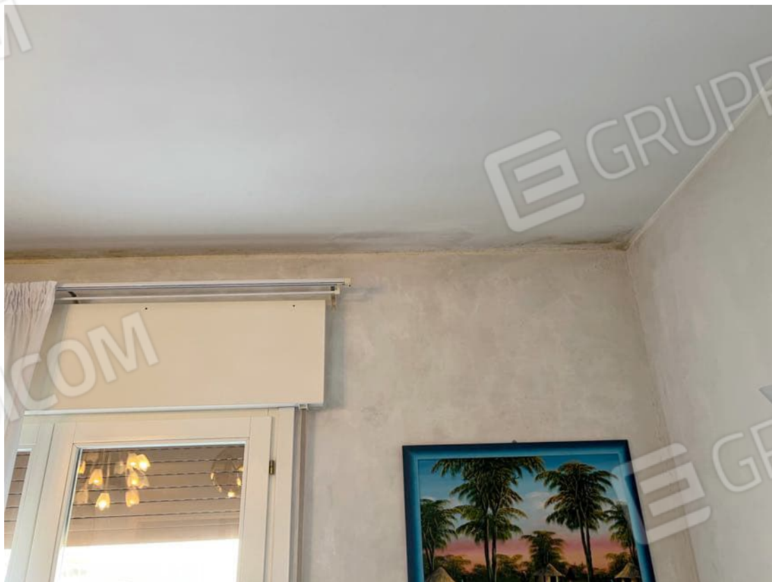
Foto n. 16 Presenza di muffe tra soffitto e muro perimetrale nel soggiorno
