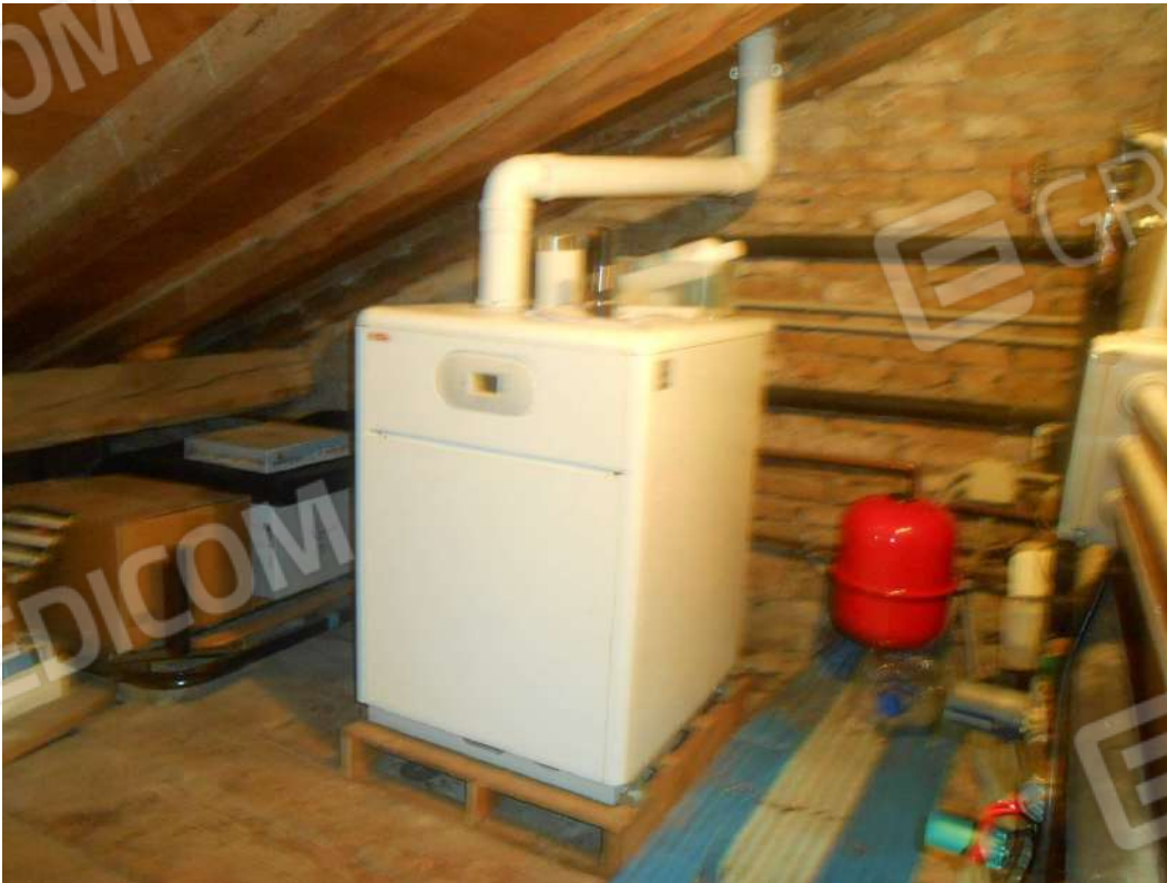
SOTTOTETTO – LOCALE CALDAIA
