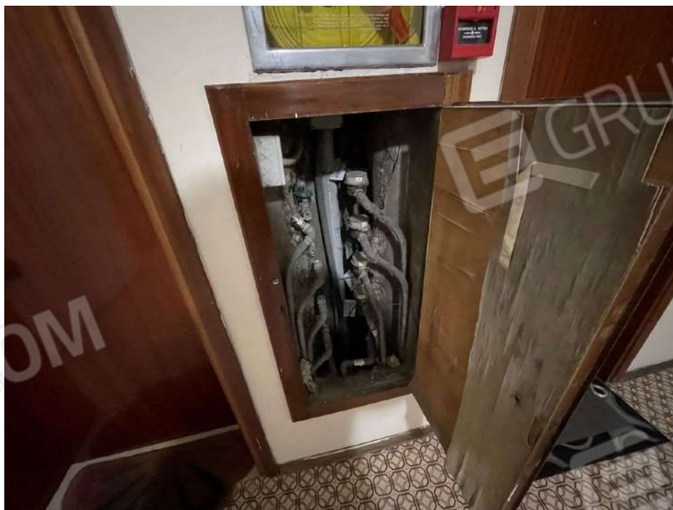
Particolare collettore al piano acqua potabile
