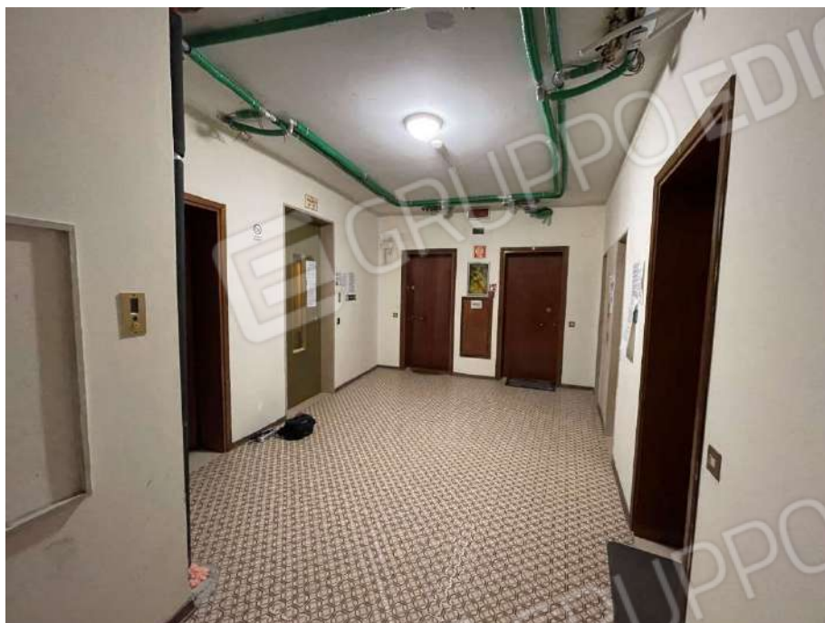
Particolare pianerottolo 11° piano con le predisposizioni riscaldamento
