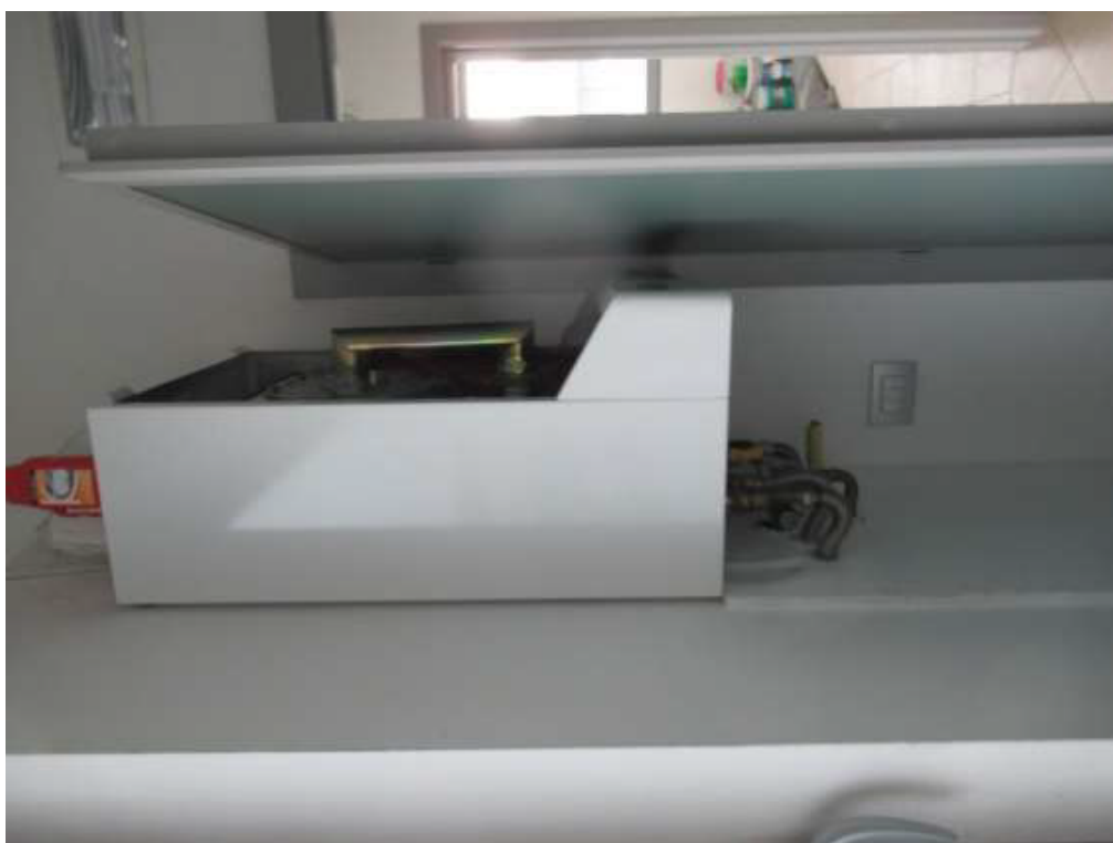
Foto n. 10 : C.F. Fg. 13 mapp. 708 - Caldaia
