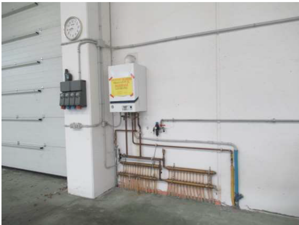
Foto n. 8 : C.F. Fg. 13 mapp. 708 - Laboratorio, impianto di distribuzione
