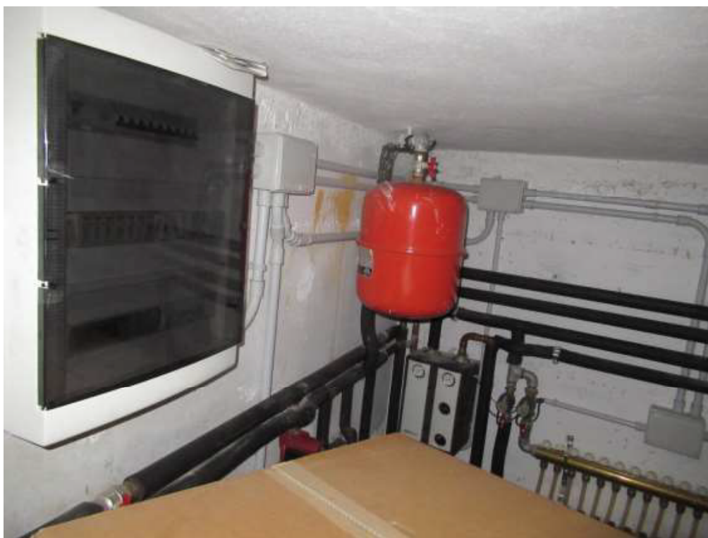
Foto n. 11 : C.F. Fg. 13 mapp. 708 - Impianto termosanitario e quadro elettrico
