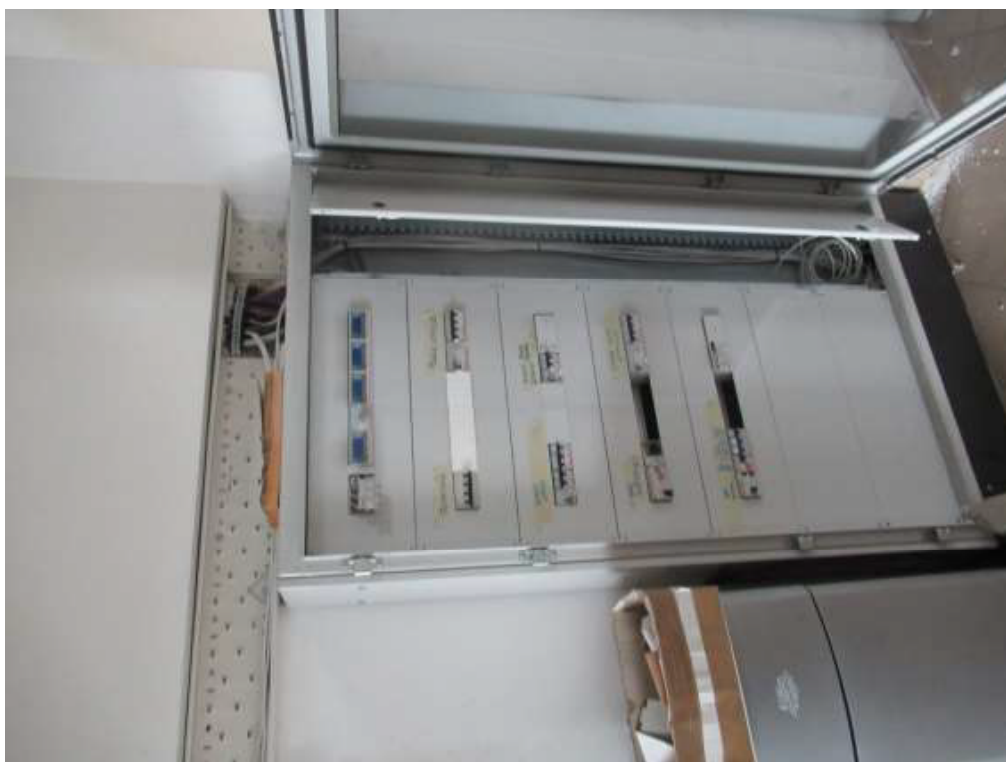
Foto n. 6 : C.F. Fg. 13 mapp. 708 - Laboratorio, quadro elettrico
