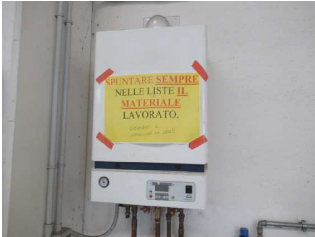
Foto n. 7 : C.F. Fg. 13 mapp. 708 - Laboratorio, caldaia
