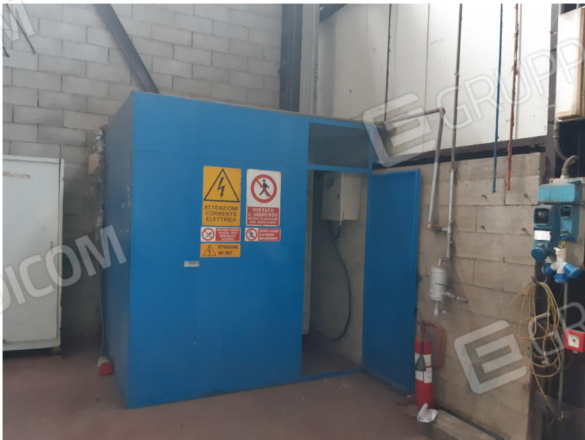
Figura 25: Cabina interna Quadro Elettrico
