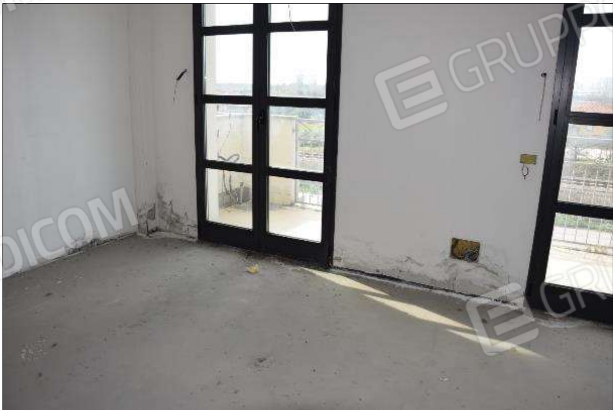
FOTO 18 – particolare - infiltrazioni d'acqua dalla terrazza
