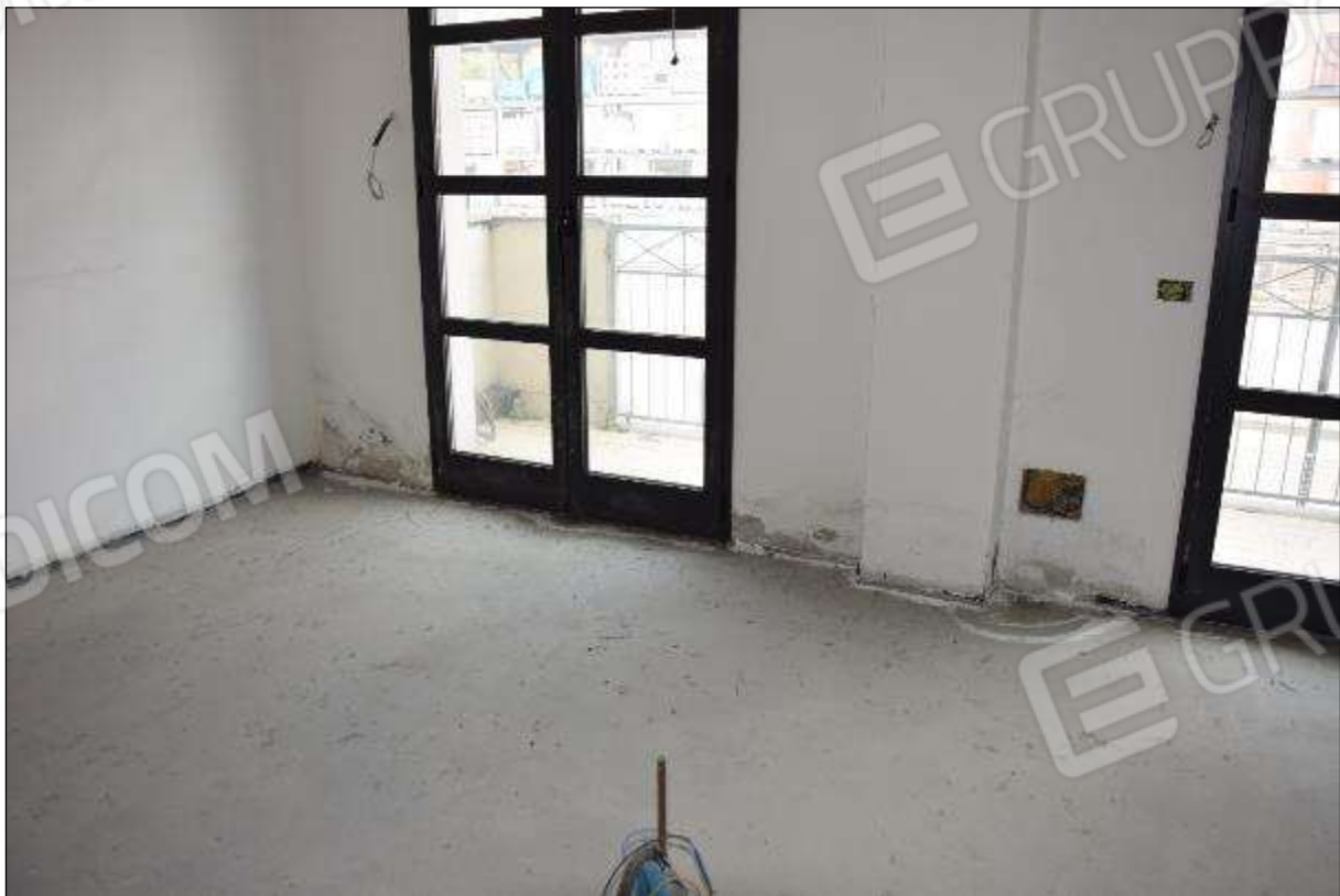
FOTO 66 – particolare - infiltrazioni d'acqua dalla terrazza
