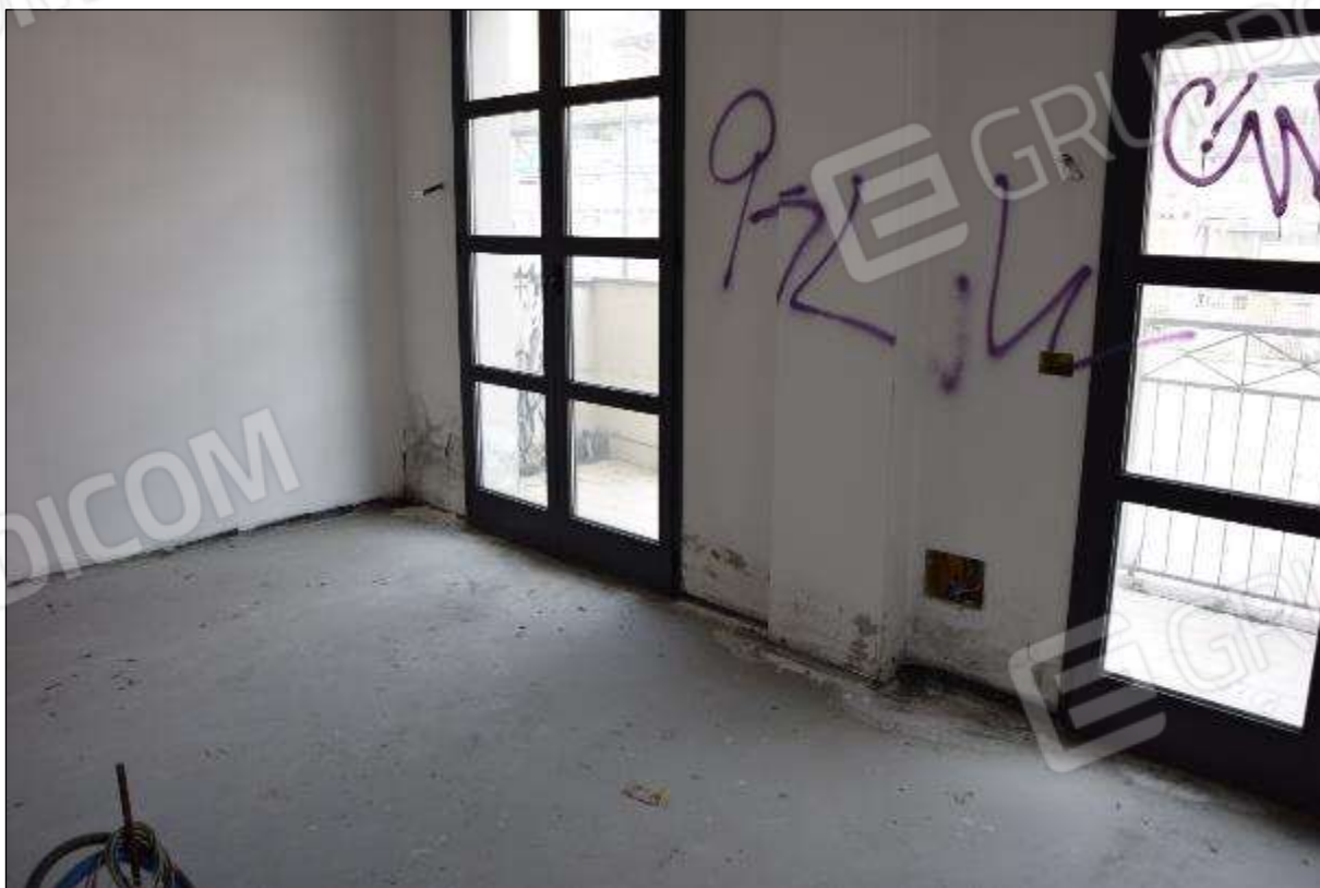
FOTO 78 – particolare - infiltrazioni d'acqua dalla terrazza
