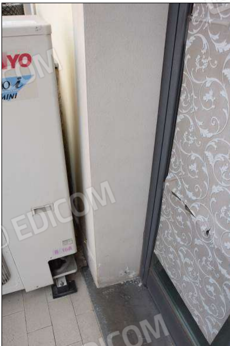
FOTO 11 – infiltrazione di umidità
