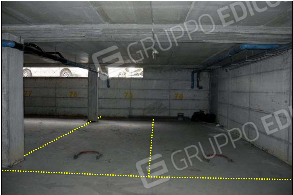
FOTO 1 – SUB 93 (POSTO 75) / SUB 94 (POSTO 74)
