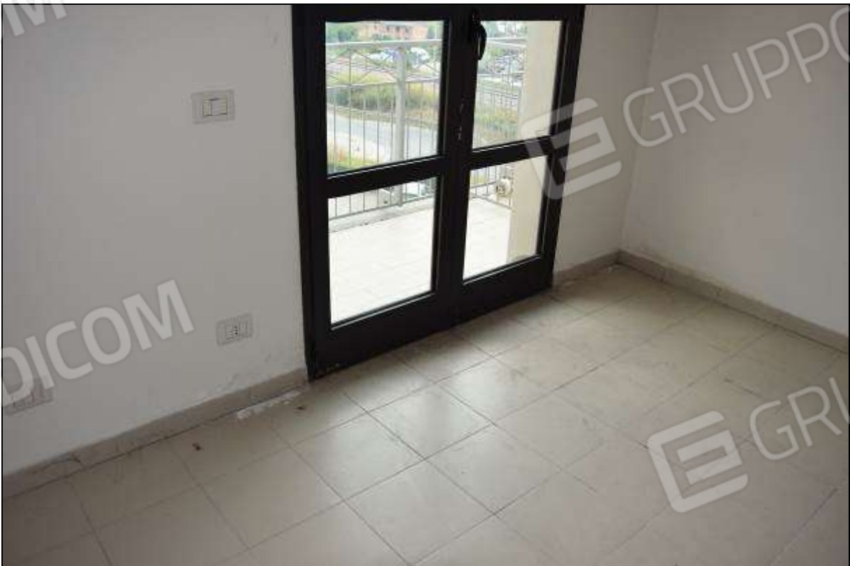
FOTO 25 – infiltrazioni di umidità
