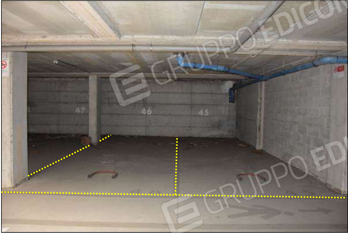
FOTO 1 – SUB 104 (POSTO 46) / SUB 105 (POSTO 45)
