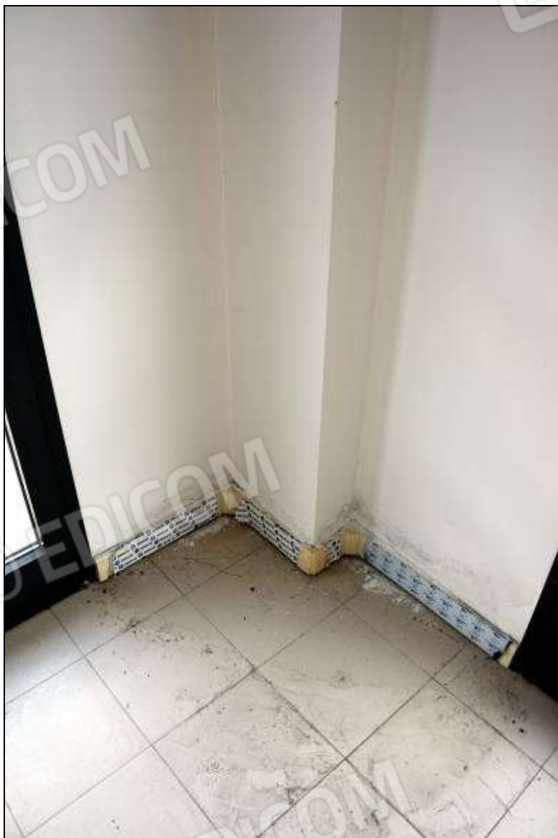
FOTO 11 – infiltrazioni di umidità
