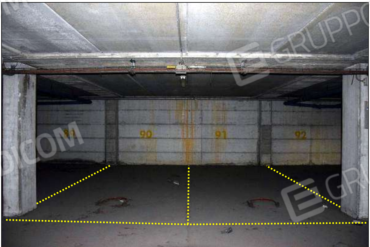
FOTO 6 – SUB 77 (POSTO 90) / SUB 78 (POSTO 91)
