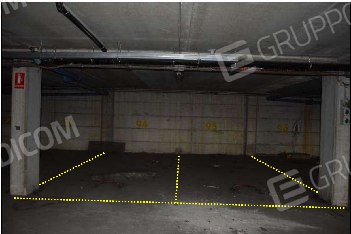
FOTO 8 – SUB 81 (POSTO 94) / SUB 82 (POSTO 95)
