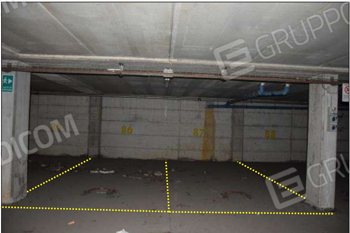
FOTO 4 – SUB 73 (POSTO 86) / SUB 74 (POSTO 87)
