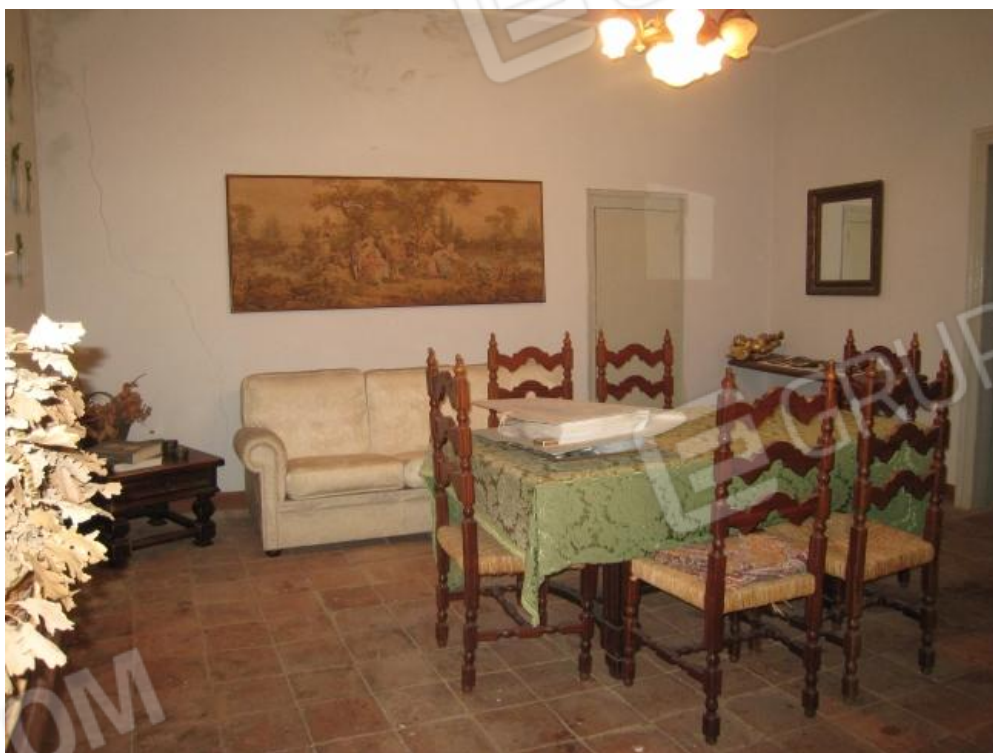
Foto n. 36. Altra inquadratura della sala da pranzo. Sono visibili macchie di umidità e lesione alla muratura.
