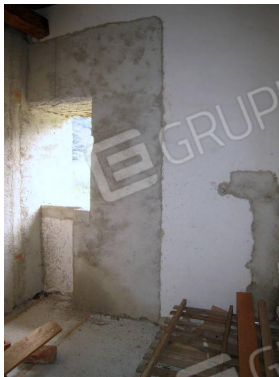
Foto n. 24. L'altro w.c. ancora al grezzo.
