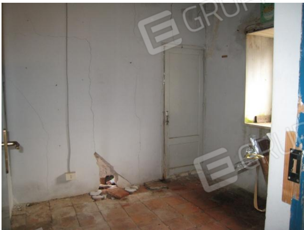
Foto n. 42. Il secondo ripostiglio adiacente la cucina, anch'esso in pessime condizioni.
