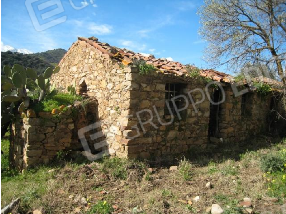
Foto n. 72. Edificio ad un solo piano fuori terra. Le condizioni sono pessime.
