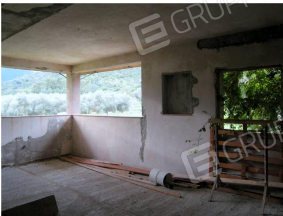
Foto n. 17. Altra immagine dello stesso ambiente abusivo.
