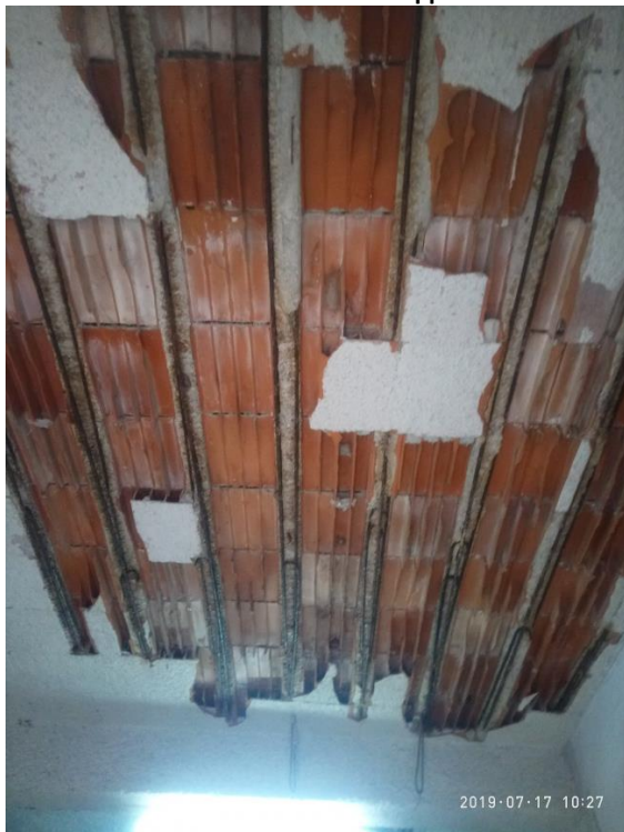
Dettaglio del solaio sfondellato del magazzino
