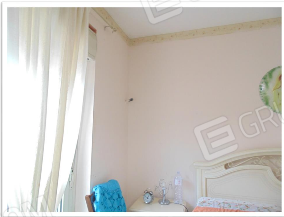
Foto 23 particolare tubi riscaldamento
